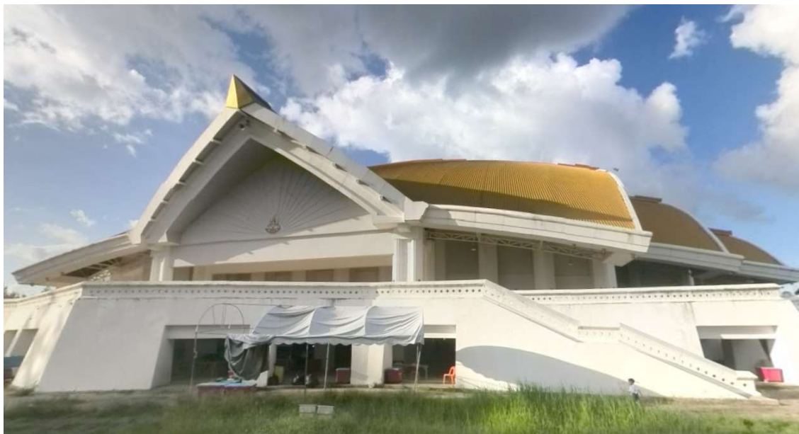
ภาพที่ 4.29 ความเสียหายของอาคารสำนักงานอธิการบดี อาคาร 1
