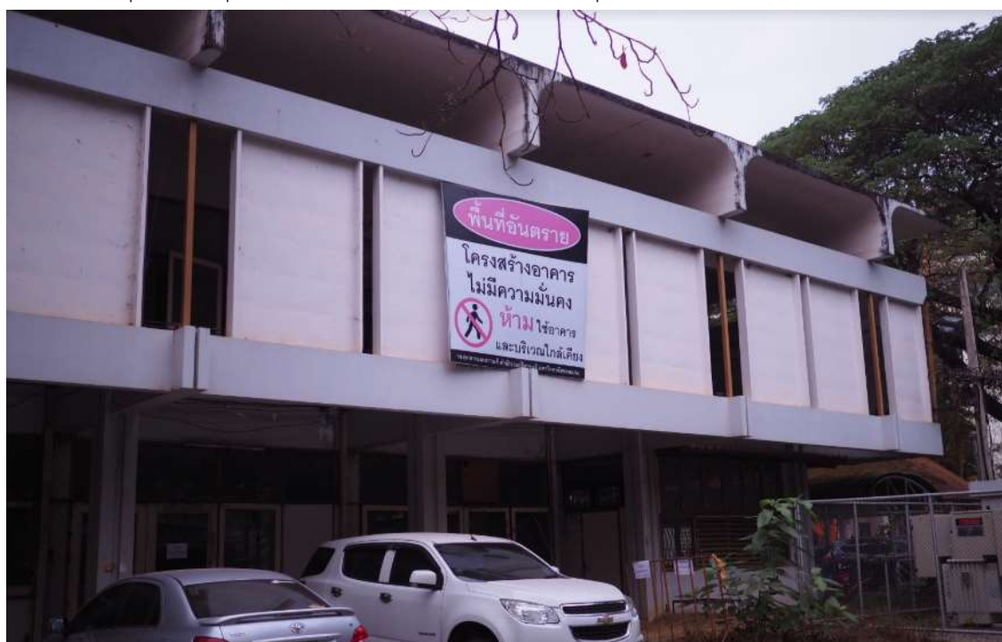
ภาพที่ 4.28 ความเสียหายของอาคารสำนักงานอธิการบดี อาคาร 1
